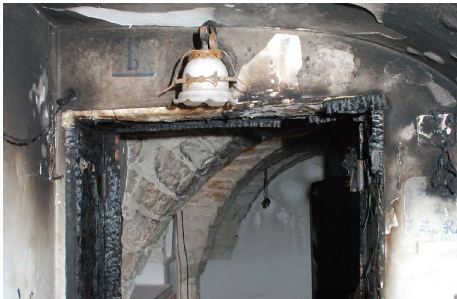
UNO DEI DUE LOCALI DEVASTATI DALLE FIAMME. I PROPRIETARI, NONOSTANTE IL DANNO, SI SONO SUBITO PRODIGATI AFFINCHÉ LE DUE ATTIVITÀ POTESSE RIPARTIRE AL PIÙ PRESTO, POSIZIONANDO DUE PORTE IGNIFUGHE ALL'INGRESSO
